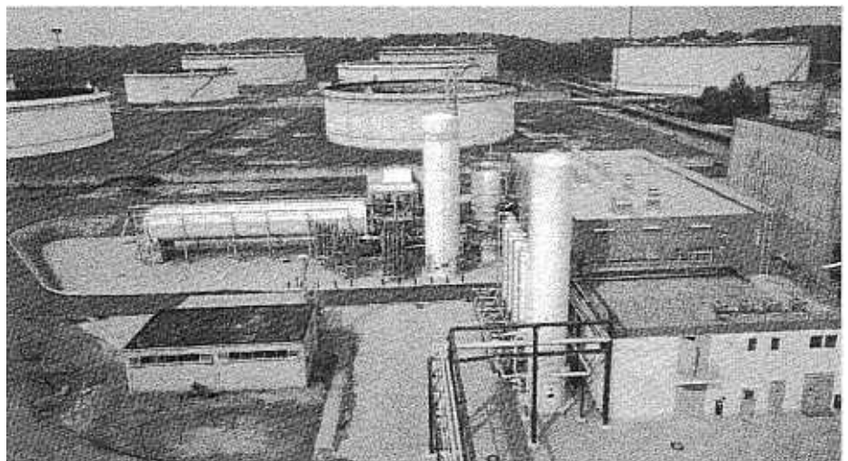
Bild 3 Gesamtansicht der Wasserstoffanlage mit Blick auf das Maschinenhaus, die PSA-Anlage, Verflüssiger Coldbox, LN 2 -Speicher und den LH 2 -Speicher
