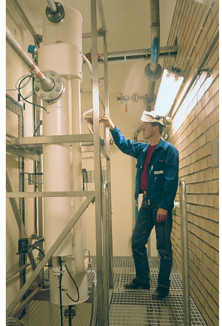
Die erste CIRRUS® M50-Anlage. Zur Erhöhung der Kapazität wurde sechs Jahre später eine zweite Anlage in Betrieb genommen.
