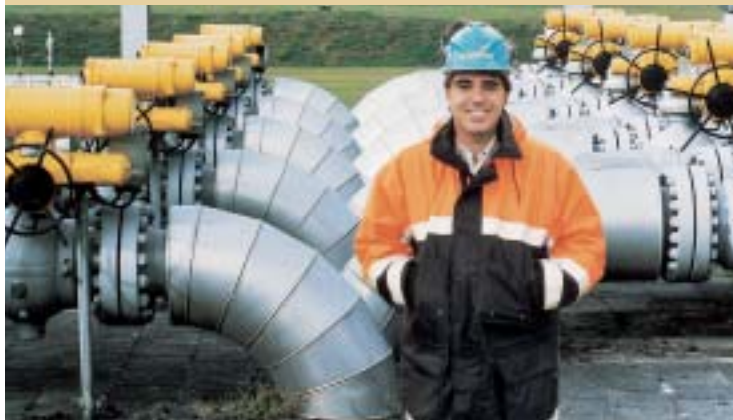
Stickstoff wird dem Erdgasgemisch stufenweise zugesetzt, bis der gewünschte Brennwert erreicht ist.
