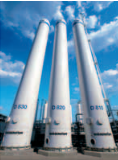
Drei Pufferspeicher für gasförmigen Wasserstoff in Burghausen.
