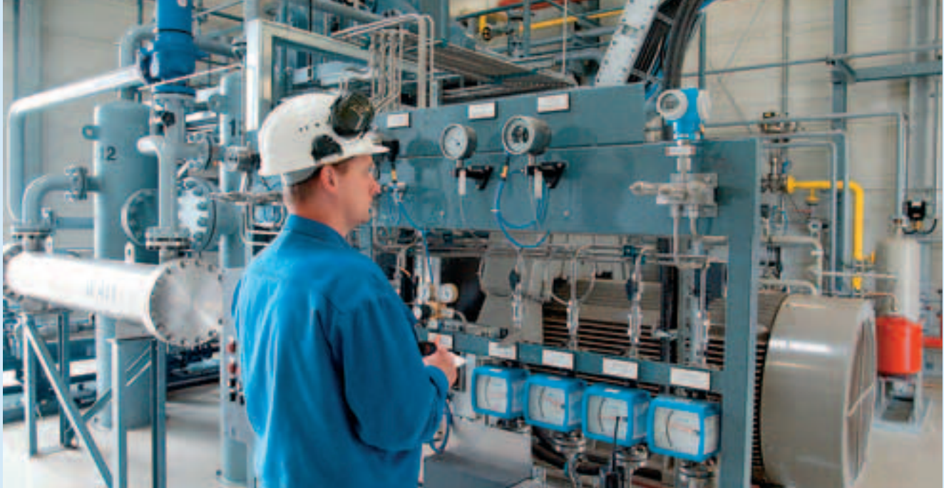
Dampfreformierungsanlage (Steam-Reformer) von Linde in Leuna: Mit steigender Nachfrage nach Wasserstoff wird auch innovative Technik zu Produktion, Speicherung, Transport und Verwendung des Gases in zunehmendem Maße gefragt sein.
