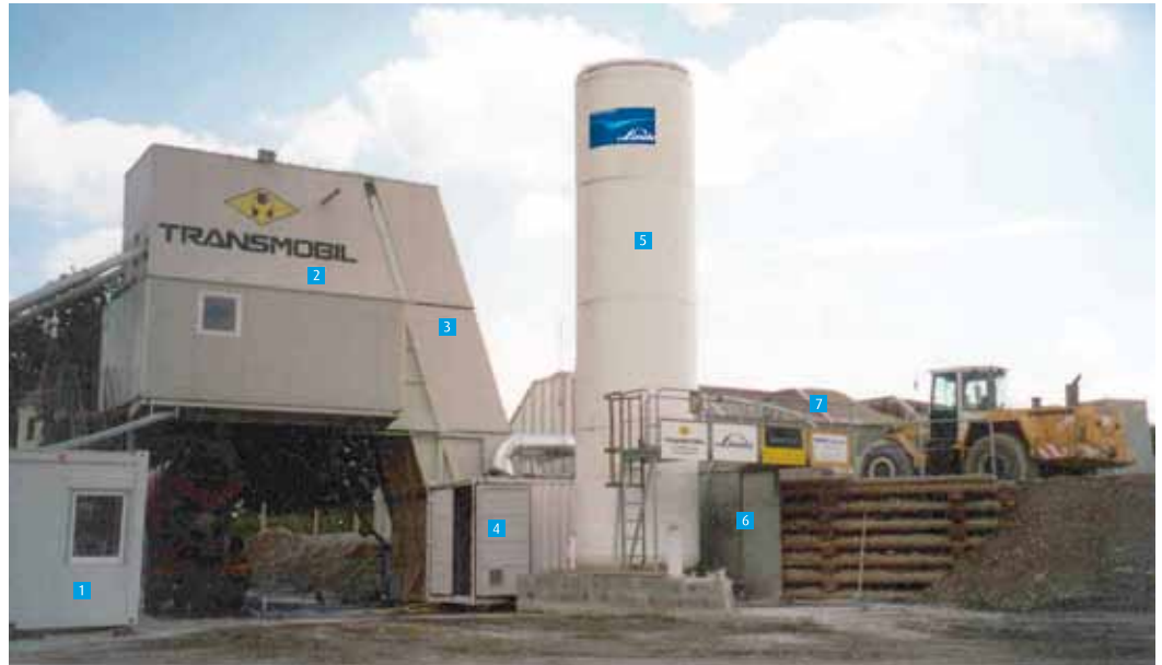
Lieferbetonwerk mit Kühlanlage beim Bau des Eisenbahnknotens Melk.
