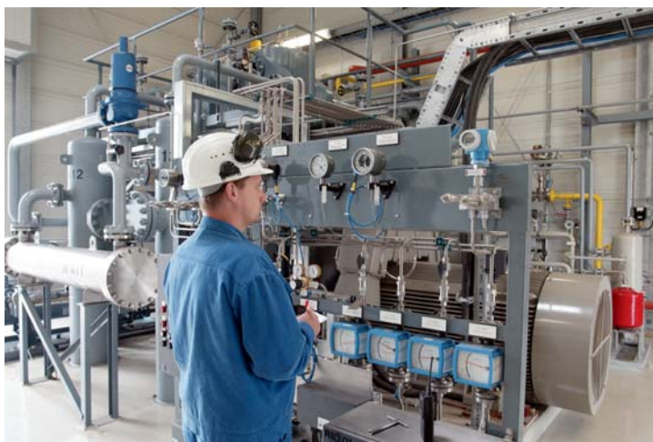
Dampfreformierungsanlage (Steam-Reformer) von Linde in Leuna: Mit steigender Nachfrage nach Wasserstoff wird auch innovative Technik zu Produktion, Speicherung, Transport und Verwendung des Gases in zunehmendem Maße gefragt sein.
